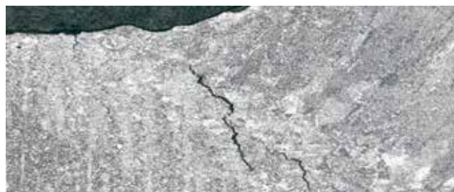
图7。T型角焊缝中典型的氢致冷裂。
